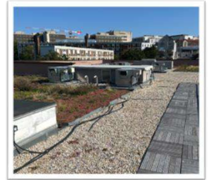
Vue terrasse : une absence de séparations d'accès avec les installations techniques
